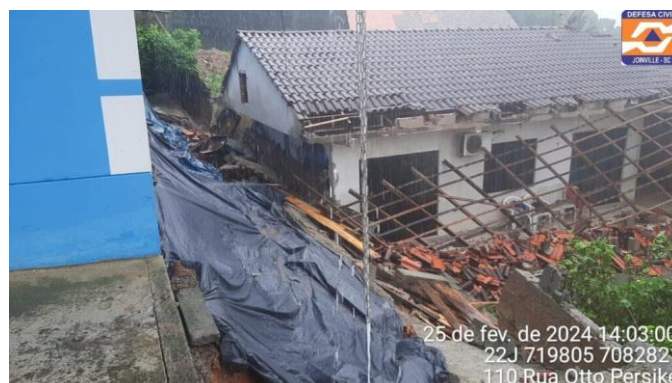
Foto: Defesa Civil do município de Joinville.
