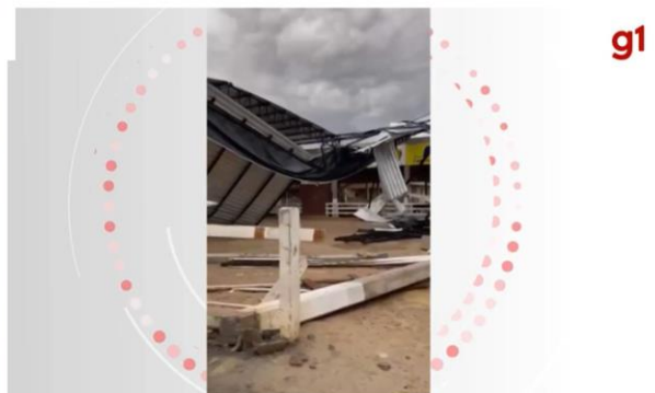
Danos em Urubici destruído por tempestade
