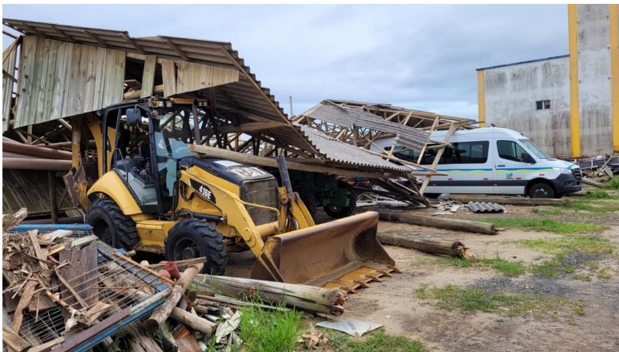
Garagem cede e cai em cima de veículos na Secretaria de Obras de Balneário Arroio do Silva — Foto: Maicon Marinho/NSC TV
