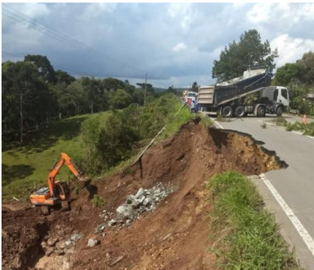
Km 41 da Serra Dona Francisca foi bloqueado devido a novo desmoronamento (Foto: PMRV)
