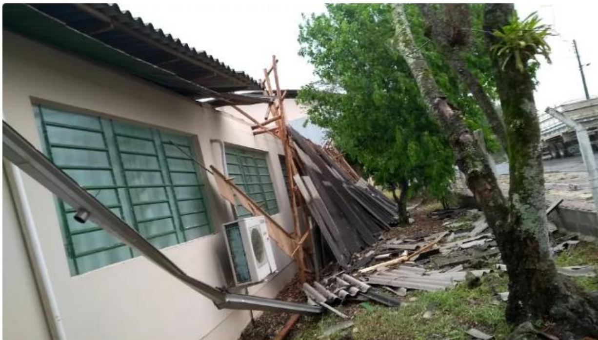
o Parte de telhado de escola municipal em Forquilha desabou (Foto: Assessoria/Prefeitura de Forquilha)
