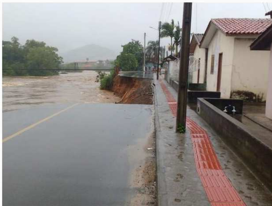
Em São Ludgero, erosão fez desaparecer uma rua em meio ao rio - Defesa Civil de São Ludgero
