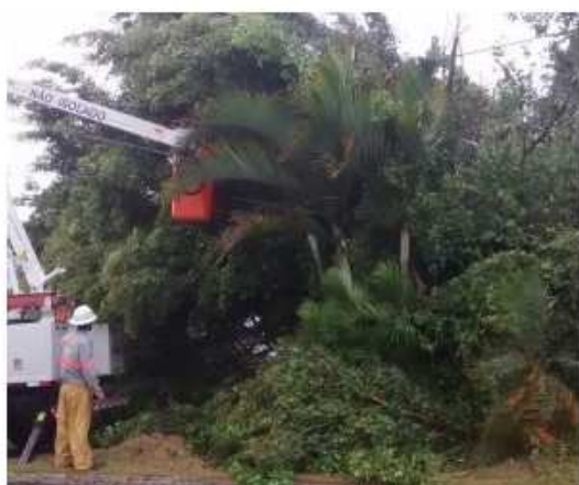
Árvore caiu sobre os fios de luz no bairro Bela Vista, em São José
